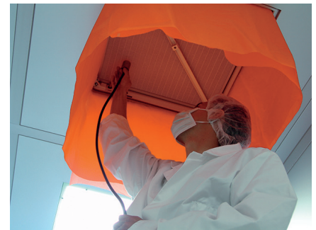
Abbildung 4: Abfahren eines HEPA-Filters mittels runder Sonde.
